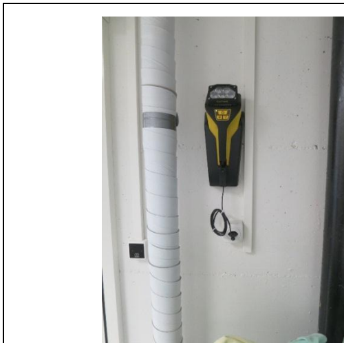
Für die Notbeleuchtung in der Wäscherei wurden Handleuchten montiert. (Auditbericht 2017 / Punkt 01).
