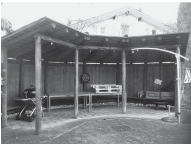
Alter Pergol: Der alte Holzunterstand auf der Rückseite des Wohnstudios war nicht mehr stabil.
